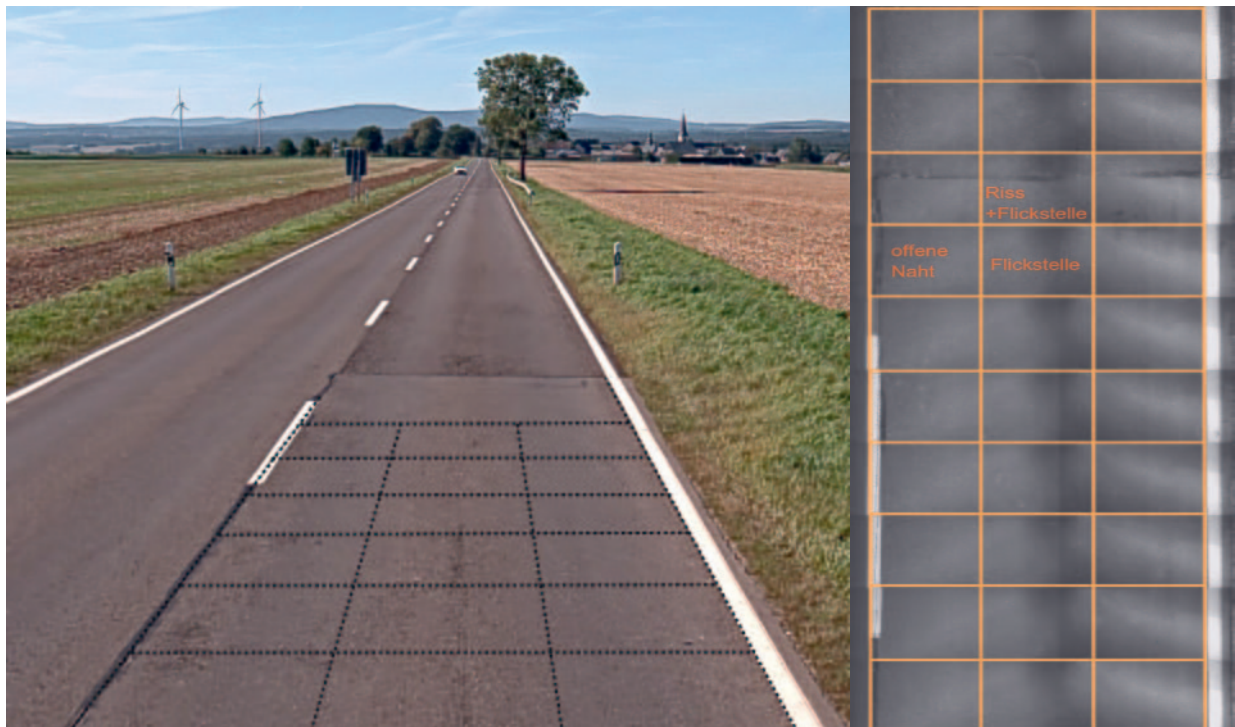
Abb. 62: Links: Rasterfelder in einem Frontkamerabild zur Veranschaulichung; Rechts: Rasterfelder in einem Oberflächenbild, welche auf Oberflächenschäden ausgewertet werden (Fotos: Ingenieurgesellschaft Heller GmbH)
